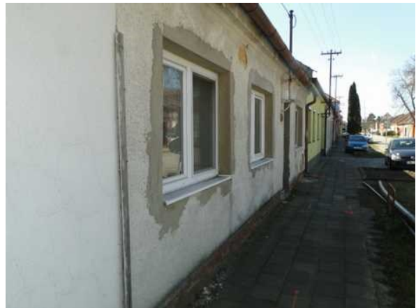
Zhoršený stavebně technický stav
