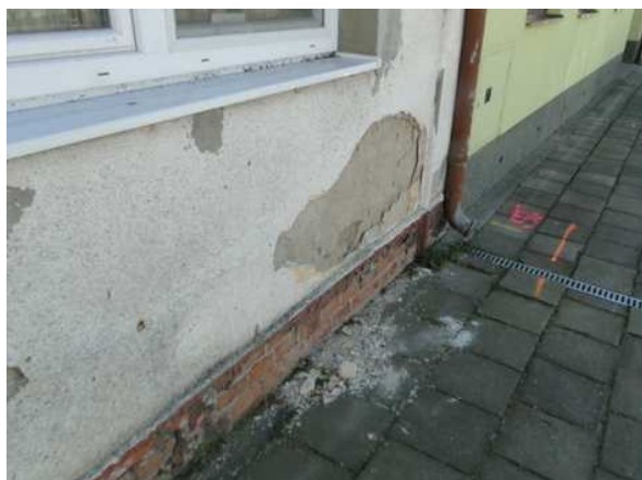
Zhoršený stavebně technický stav RD
