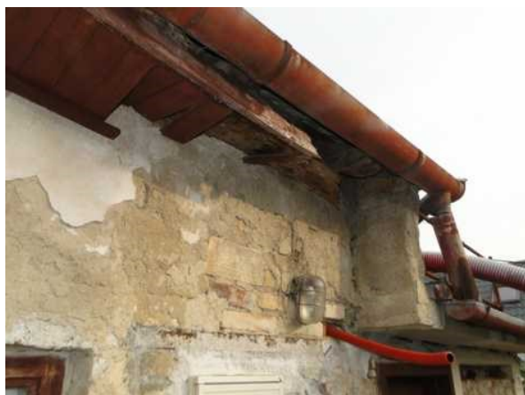
Zhoršený stav RD
