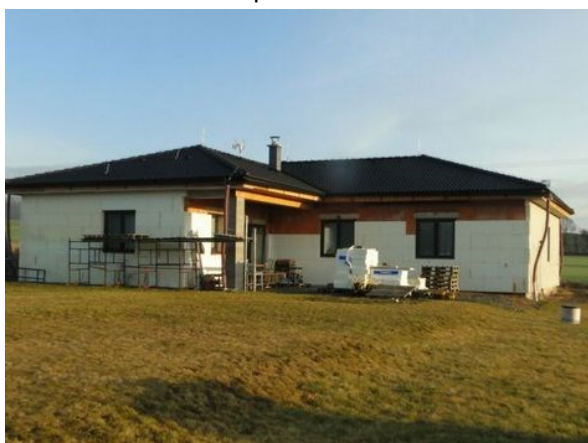
Boční pohled na RD (nedokončené zateplení)
