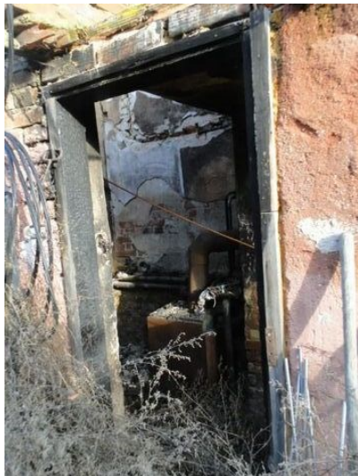
Vyhořelá část RD
