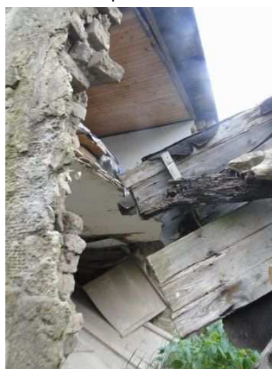
Havarijní stav RD
