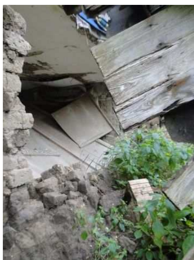
Havarijní stav RD
